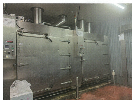
原料窒素急速凍結機 （入荷バース内）
